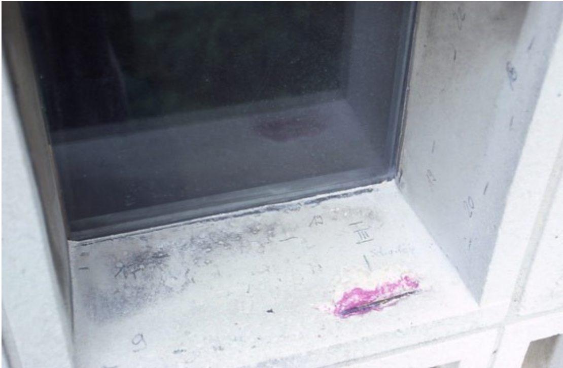
Abb. 16 Kestner-Museum Hannover, sondierte und auf der Betonwabe angezeichnete Bewehrungseisen
