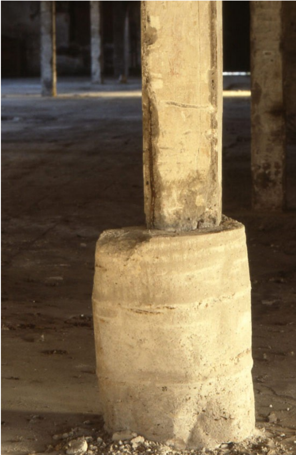
Abb. 36 Stütze mit beschädigten Kanten und Betonummantelung zur Kaschierung eines Bruches
