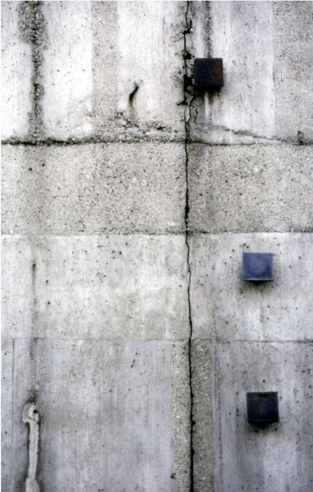
Abb. 8 Riss in der Betonumfassungswand des Beethovensaales der Liederhalle Stuttgart, erbaut 1955/56
