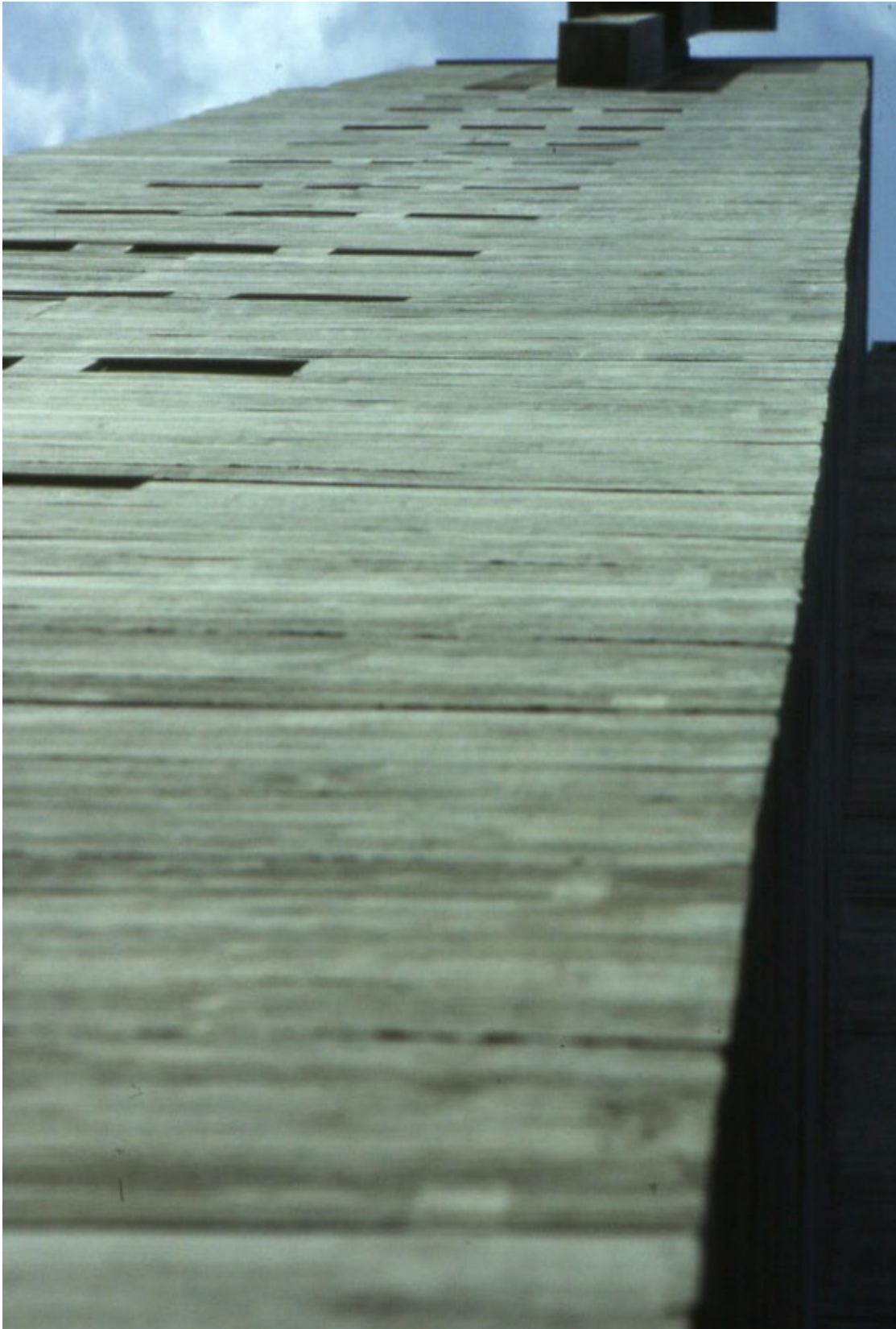
Abb. 20 Turmkanten und Betonflächen der Antoniuskirche in Basel nach der Betoninstandsetzung
