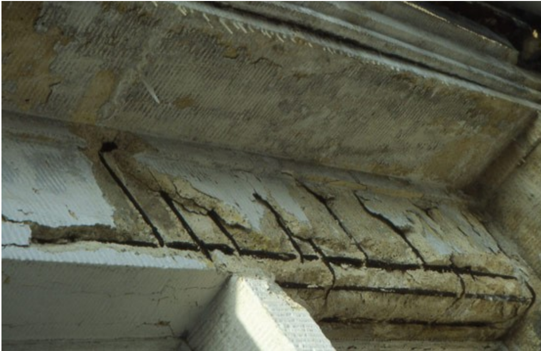
Abb. 6 Korrodierende Bewehrung und abgesprengte Betonüberdeckung am Speisehaus der Nationen Berlin, erbaut zur Olympiade 1936
