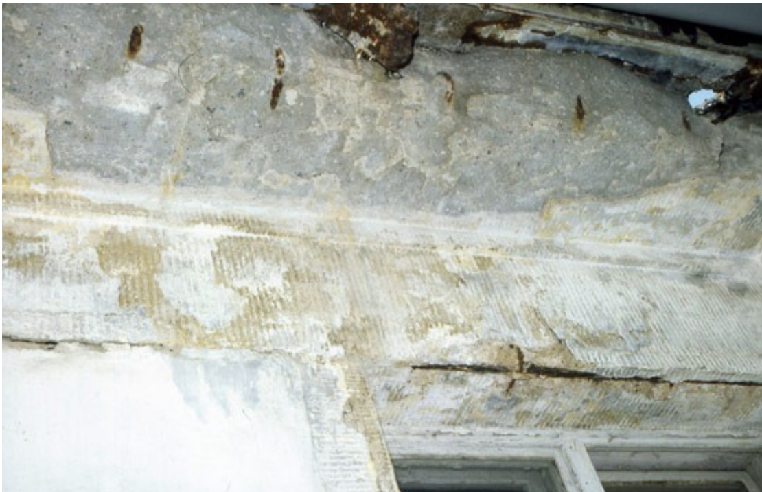
Abb. 7 Verwittertes Traufgesims am Speisehaus der Nationen Berlin
