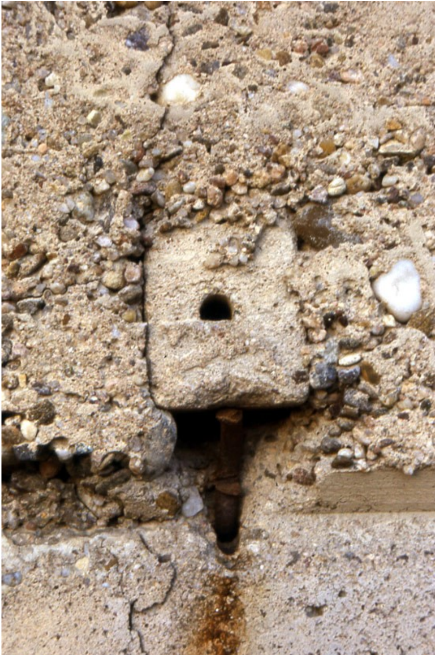
Abb. 24 Abstandshalter und gealterter Beton in der Fassade des Beethovensaales der Liederhalle Stuttgart
