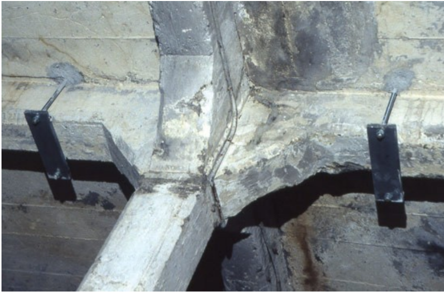
Abb. 38 Rückverhängung der Eisenbetonunterzüge mit Anriss an der additiven Stahlträgerlage über der Hallendecke
