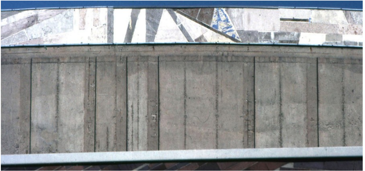
Abb. 18 Schäden auf der konvex gekrümmten Fassade des Beethovensaales der Liederhalle in Stuttgart
