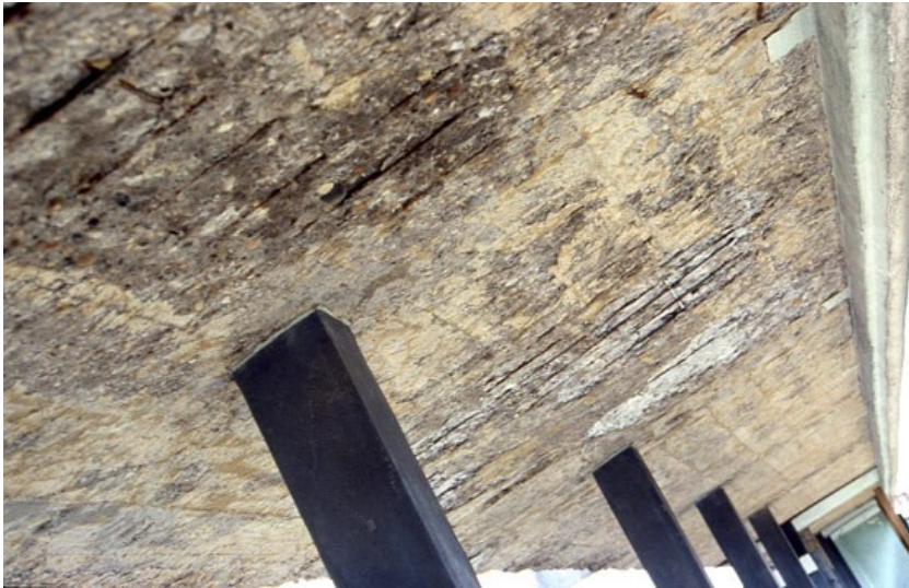
Abb. 41 Bauzustand des Flugdaches auf der Dachterrasse des Le Corbusier-Doppelhauses in der Weißenhofsiedlung in Stuttgart
