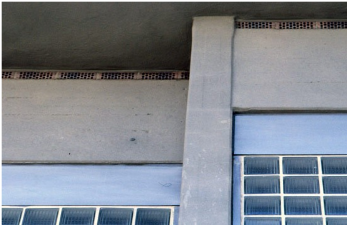
Abb. 23 Im Jahr 1986 instand gesetzte und ganzflächig mit einer Schlämme beschichtete Betonfassade des Silchersaales der Liederhalle Stuttgart
