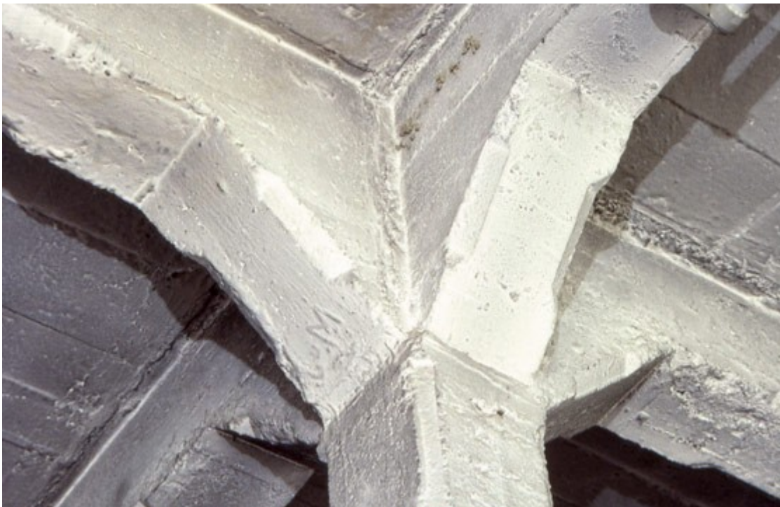
Abb. 4 Vouten, Stützen und Unterzüge mit eingesetzten gefasteten Kanten
