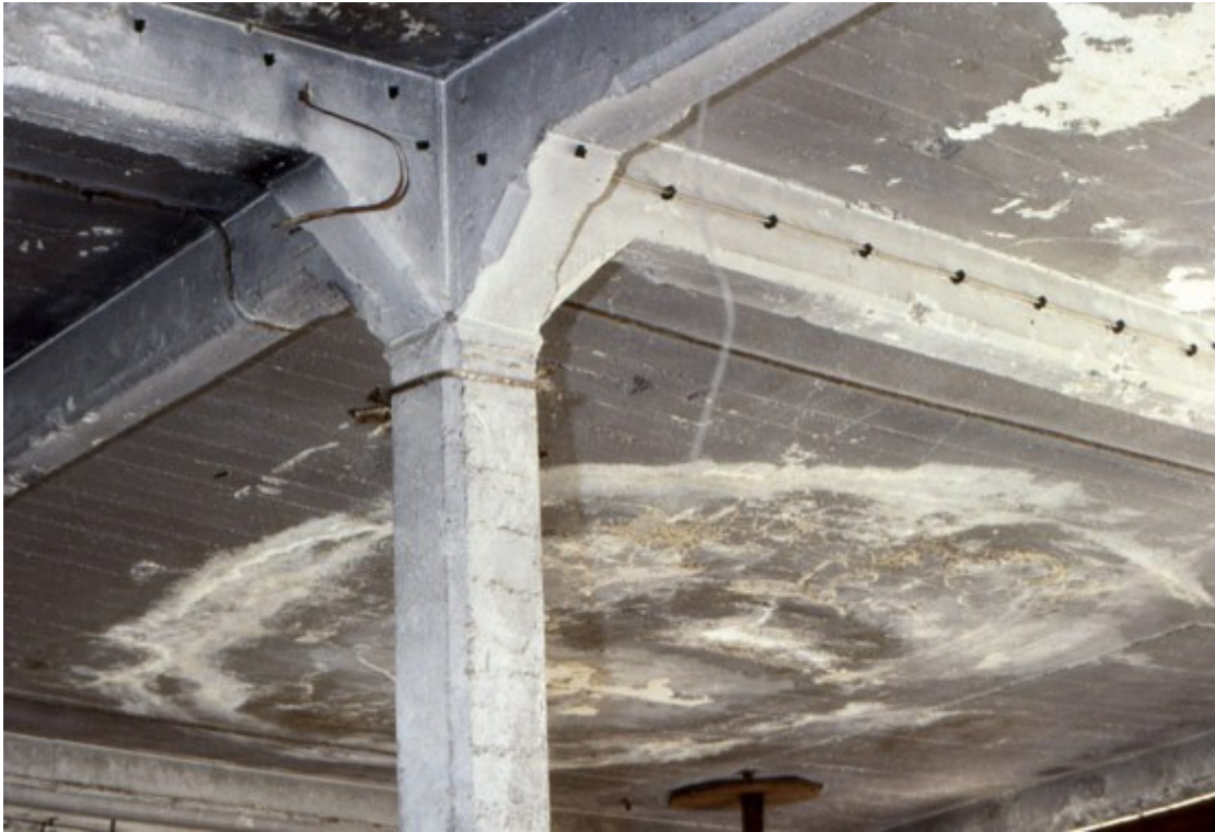
Abb. 34 Auf den durchhängenden Deckenplatten der Papierfabrik in Osthofen bildeten sich „Teiche“, auf der Unterseite kam es zu Sinterungen
