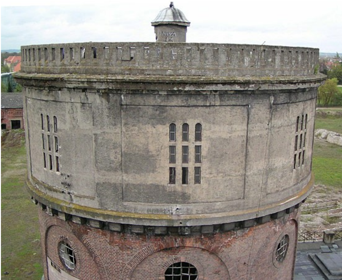
Abb. 2: Wasserturm „Kavalier Dallwigk“ in Ingolstadt, erbaut 1916-17, vor der Instandsetzung. Der Sichtbeton zeigt, neben Moos- und Algenbewuchs, eine Vielzahl von Betonschäden, wie z. B. Rissbildungen als Folge von Zwang sowie Kantenabbrüche und Abplatzungen als Folge von Frost und korrodierender Bewehrung
