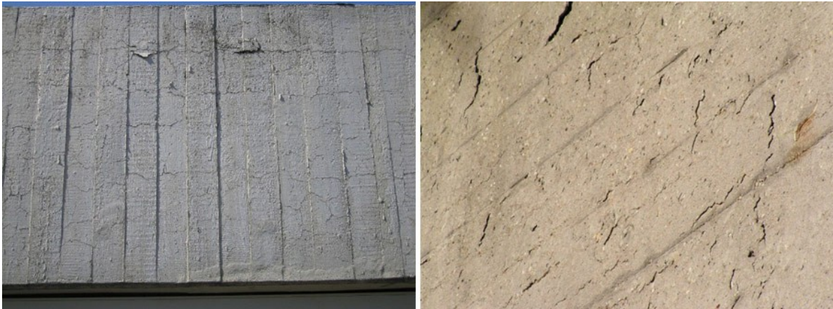
Abb. 1: Rissbildungen in einer Bauteilrandschicht als Folge von Eigenspannungen mit dadurch bedingten Ablösungen der aufgetragenen Lasur (links) und Absprengungen der Bauteilrandschicht als Folge korrodierender Bewehrung (rechts)
